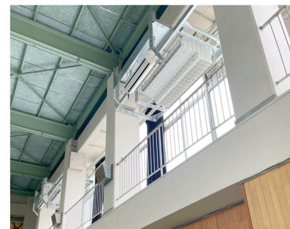
他市の空調整備設置例
