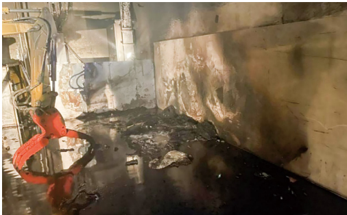
出火場所となった大型可燃ごみ受入ヤード内
