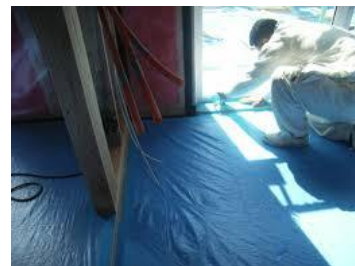
<上階からの漏水による床養生>
