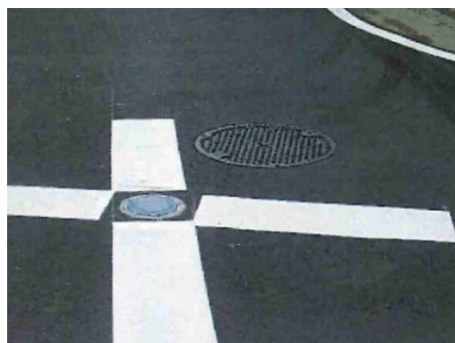
交差点発光鋸設置
