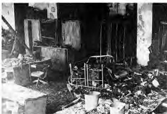
火災で焼けた市庁舎（2階）
