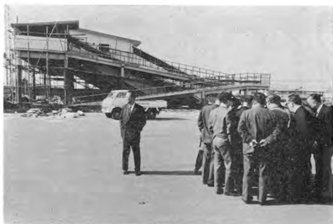
北部地域開発促進特別委員会の現地視察 （建設中の湘南台駅自由通路）議11.20
