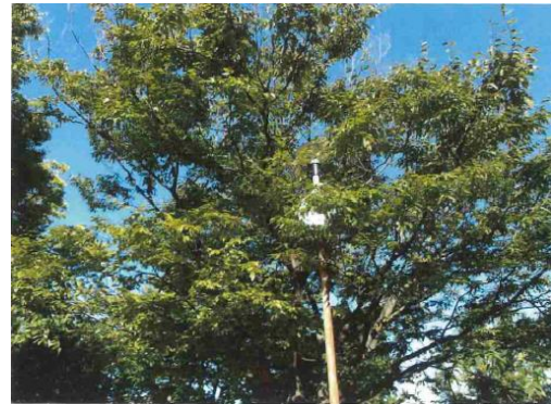
照明灯付近の支障枝
