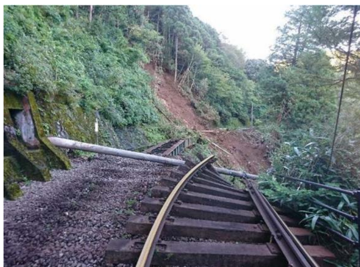
■ 2019年(令和元年)台風第19号による箱根登山鉄道の被災状況
