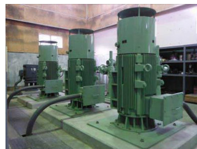
【省エネ機器の導入】 藤が谷ポンプ場 汚水ポンプ用電動機 2019（平成 31）年 3 月
