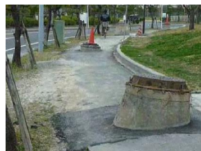
【マンホール浮上】 東日本大震災の浦安市の事例 2011（平成 23）年 3 月
