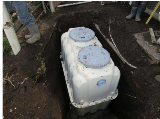
【未普及地域における助成制度を活用した浄化槽*整備】 浄化槽*整備
