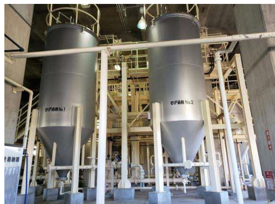
【処理水の再利用】 大清水浄化センター 砂ろ過*設備
