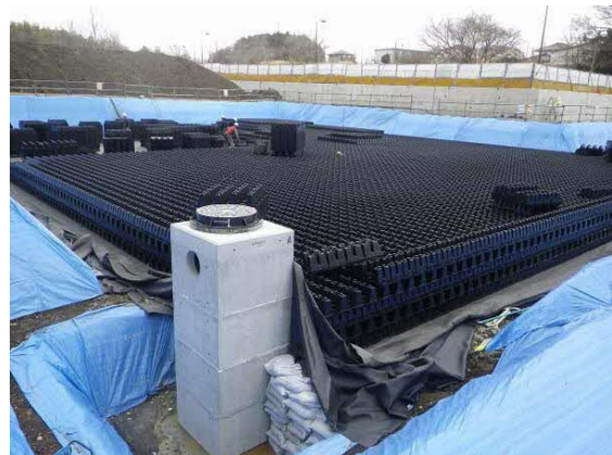
【雨水貯留施設*】 慶應義塾大学湘南藤沢キャンパス周辺地区
