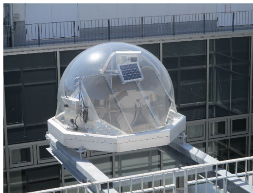
◆藤沢市役所屋上の集光器
