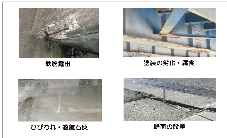
図 4 - 5 橋りょうの損傷例
